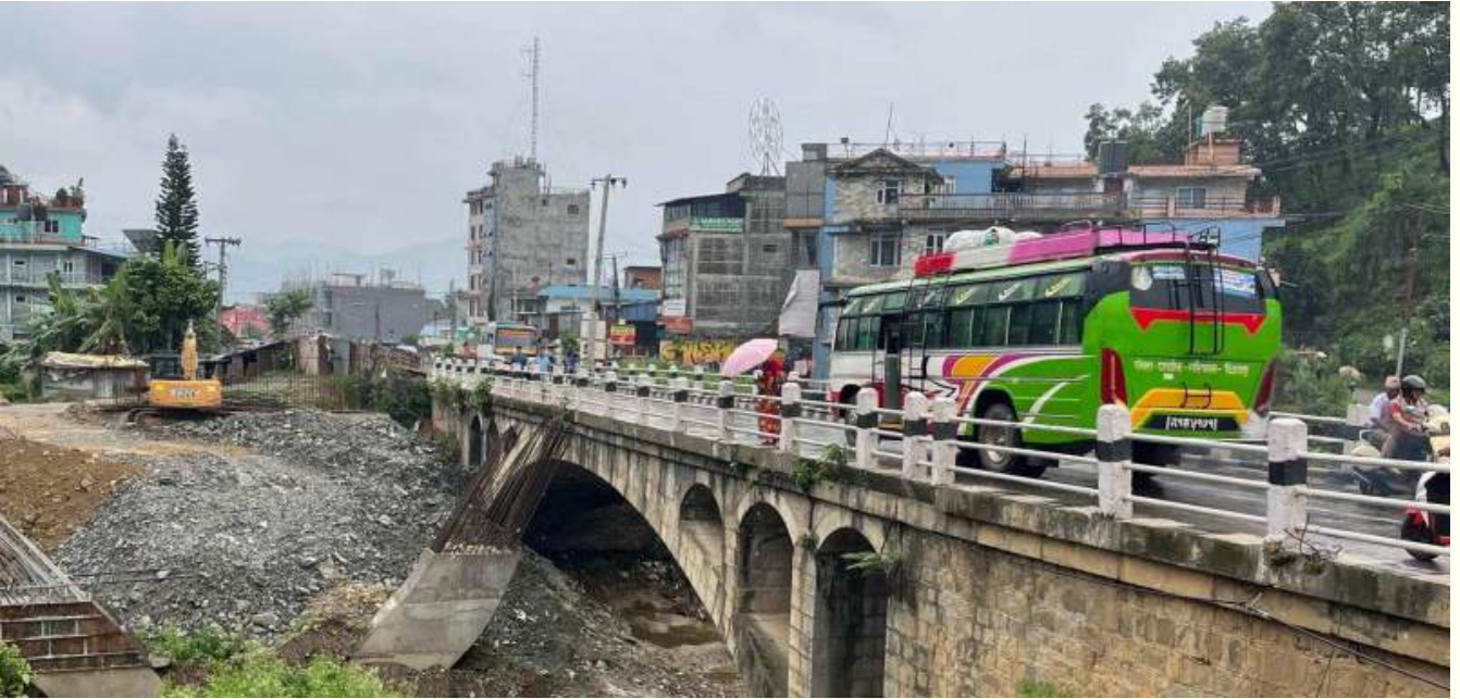
सात वर्षदेखि पोखराको फिर्केखोलामा अलपत्र परेको निर्माणाधीन पुल ।
